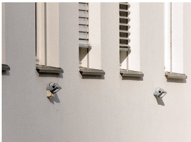
SpotLED 230 comme éclairage extérieur d'un bâtiment administratif
