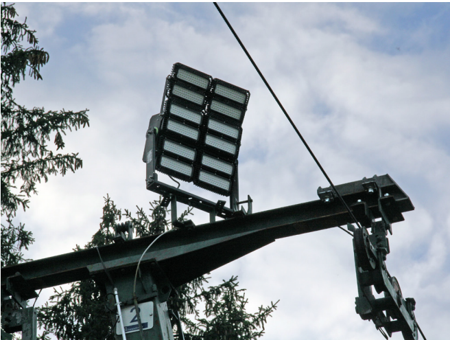
HPL 1'350W Remontées mécaniques Freistadt
